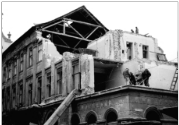
Фрагмент будинку. Руйнування протягом лютого 1998 р. Фото М.Бевза
