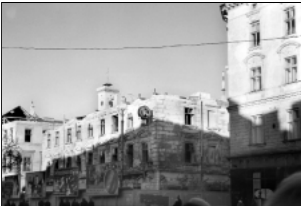
Будинок під час руйнування. Фото М.Бевза 17.01.1998 р.
