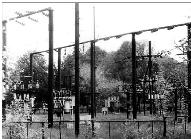
Перша відкрита підстанція ЛЕП Одеса — Біляївка (1948)
