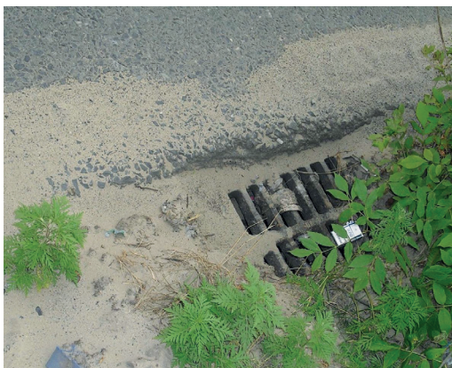
Лоток зливної каналізації на вулиці Перемоги – біля будинку № 187А на вул. Перемоги. Ось на цьому місці ко- лись протікав струмок. Це і є найдав- ніший куточок селища
