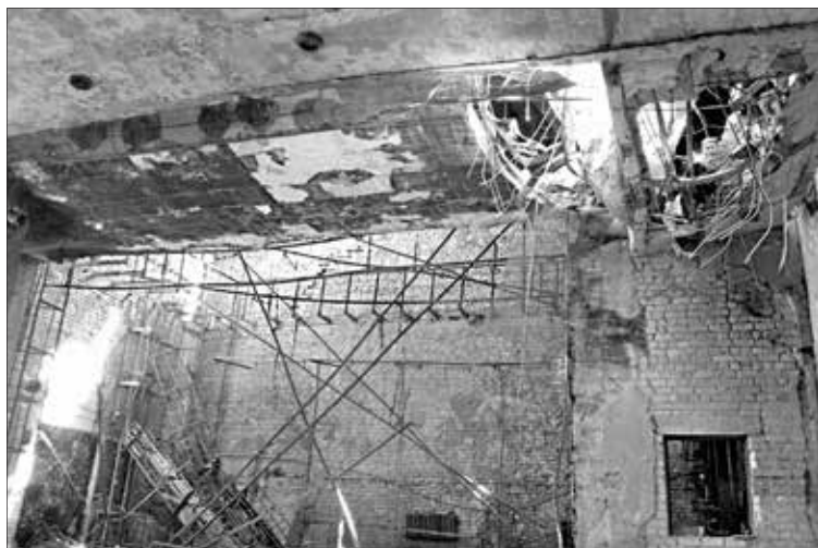
Зруйнований будинок культури у с. Новосвітлівка, серпень 2014 р.
