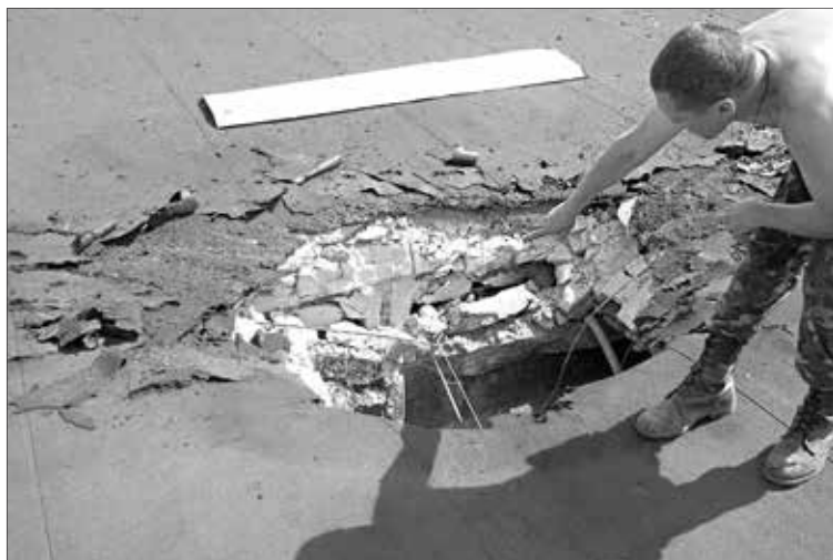
Наслідок обстрілу з РСЗО «Град» — діра у даху аеровокзалу, серпень 2014 р.
