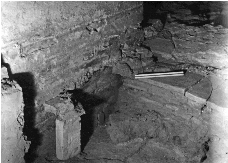
Мал. 131. Прокладання повітропроводу у вітарній частині Софійського собору. Січень 1953 р. Деформована давня підлога, перемичка з плінфи на давньому розчині та примикання фрескового тиньку до давньої підлоги. Вигляд з приділа свв. Йоакима та Анни після видалення шиферної плити та давнього ремонту підлоги (НАДР, 916, арк. 14)
