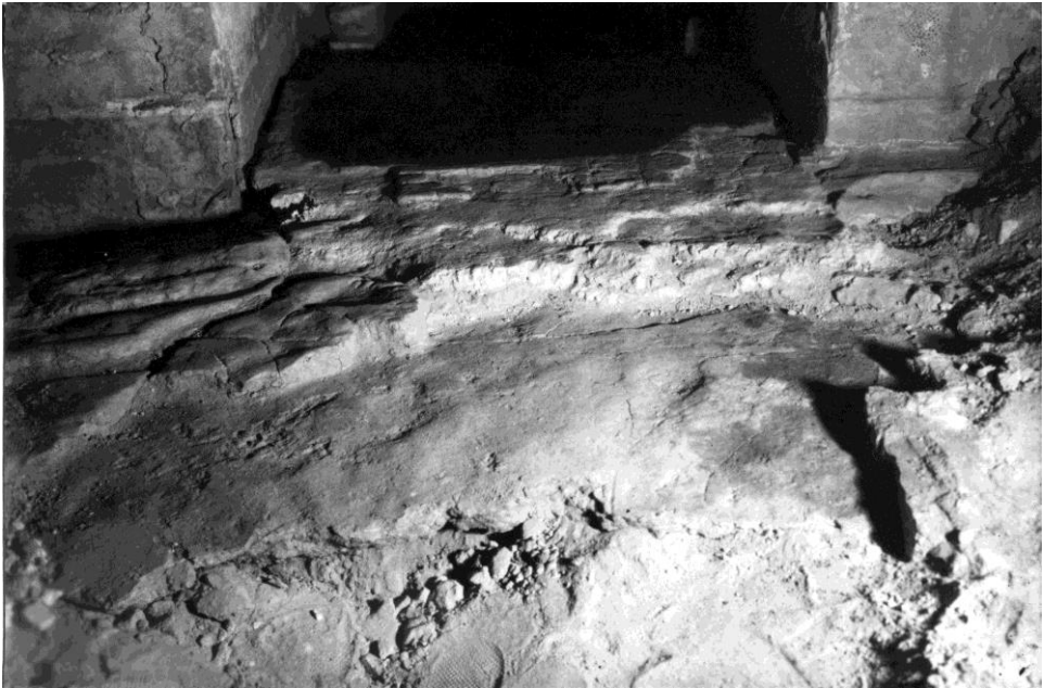
Мал. 127. Прокладання повітропроводу у вітарній частині Софійського собору. Грудень 1952 р. Ремонт давньої підлоги керамічними плитами. У проїмі шиферна плита. Вигляд з головного вітця (НАДР, 917, арк. 9)
