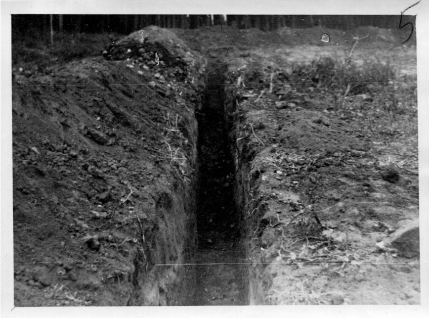
Мал. 6. Роботи з прокладання траншеї ТЕЦ, перше коліно. Вигляд з боку Софійського собору. 1945 р. (НАДР, 923, арк. 31)
