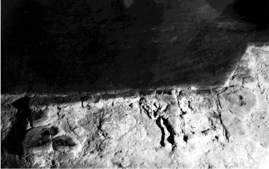
Мал. 128. Прокладання повітропроводу у віттарній частині Софійського собору. Грудень 1952 р. Ремонт давньої підлоги керамічними плитами (НАДР, 917, арк. 10)
