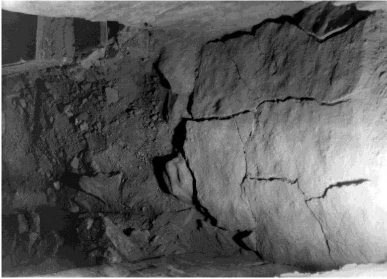
Мал. 133. Прокладання повітропроводу у вістарній частині Софійського собору. Січень 1953 р. Поверхня фундаменту, залита шаром розчину, що розтріскався та деформувалася внаслідок просідання споруди. Вигляд з приділу св. Йоакима та Анни після видалення перемички (НАДР, 917, арк. 11)
