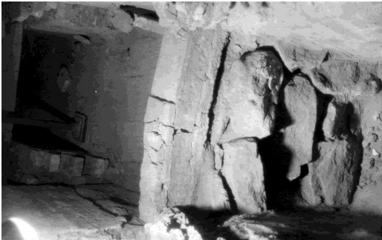
Мал. 132. Прокладання повітропроводу у вістарній частині Софійського собору. Січень 1953 р. Північна сторона стрічкового фундаменту під пройомою та перемичка з плінфи на давньому розчині. Вигляд з головного вістара (Т/3, s/p)
