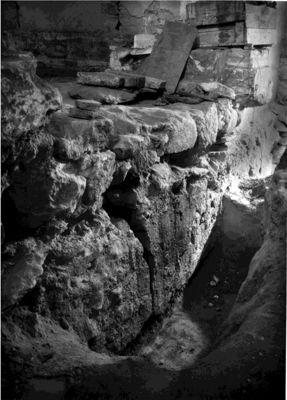
Мал. 171. Східна частина північної зовнішньої галереї (А-3). Жовтень 1955 р. Фундамент під середньою частиною східної стіни (НАДР, 916, арк. 29)
