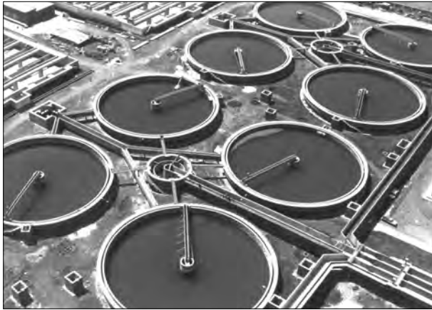
Система очистки промышленных стоков.
