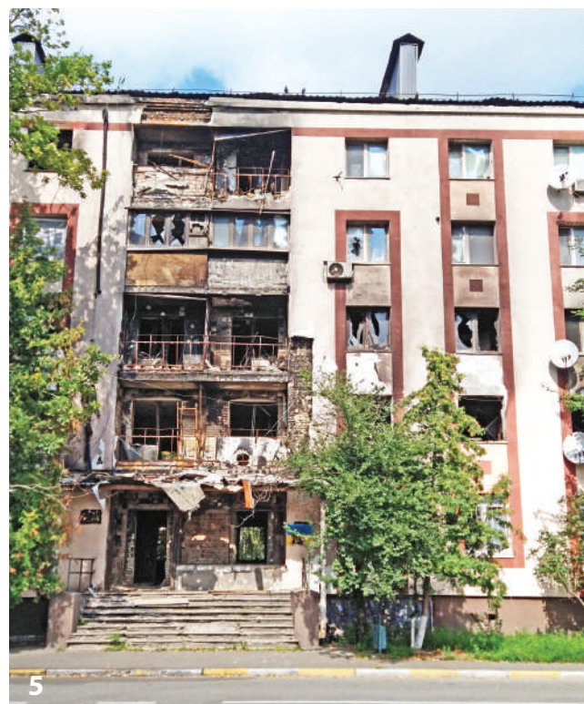
5. Пошкоджена будівля. м. Буча Київської обл. Вересень 2022 р. Світлина Л. Босої
