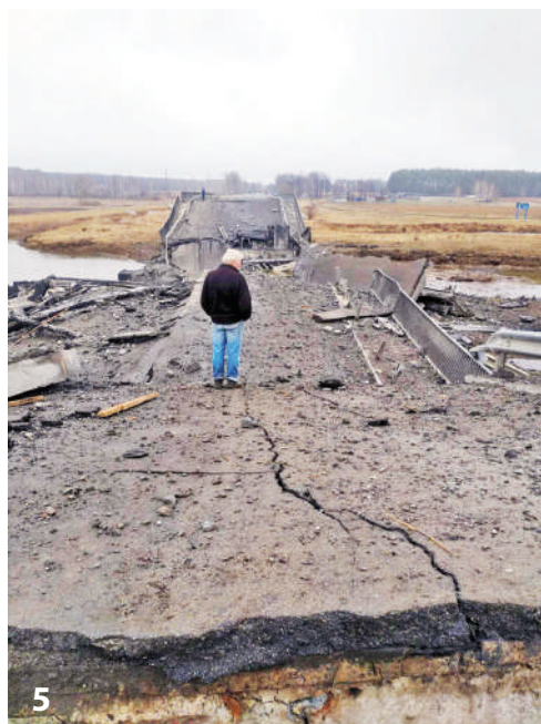
5. Зруйнований автомобільний міст. Північ Київщини. 4 квітня 2022 р. Світлина Л. Настенко
