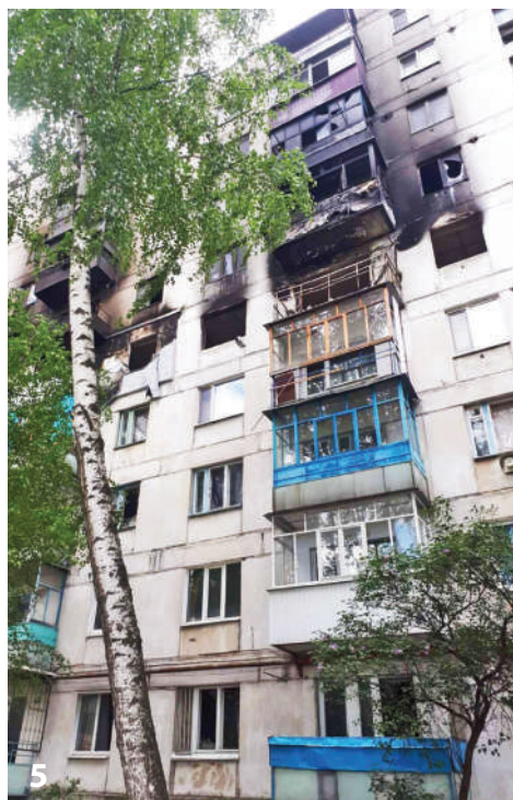
5. Обстріляний армією рф багатоквартирний будинок. м. Рубіжне Луганської обл. 2022 р. Світлина Н. Житлової
