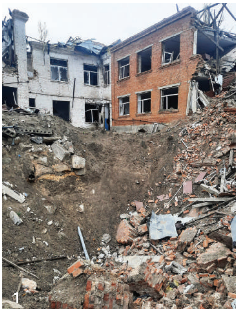
1. Зруйнована школа. м. Оріхів Запорізької обл. Березень 2024 р. Світлина В. Волошина
